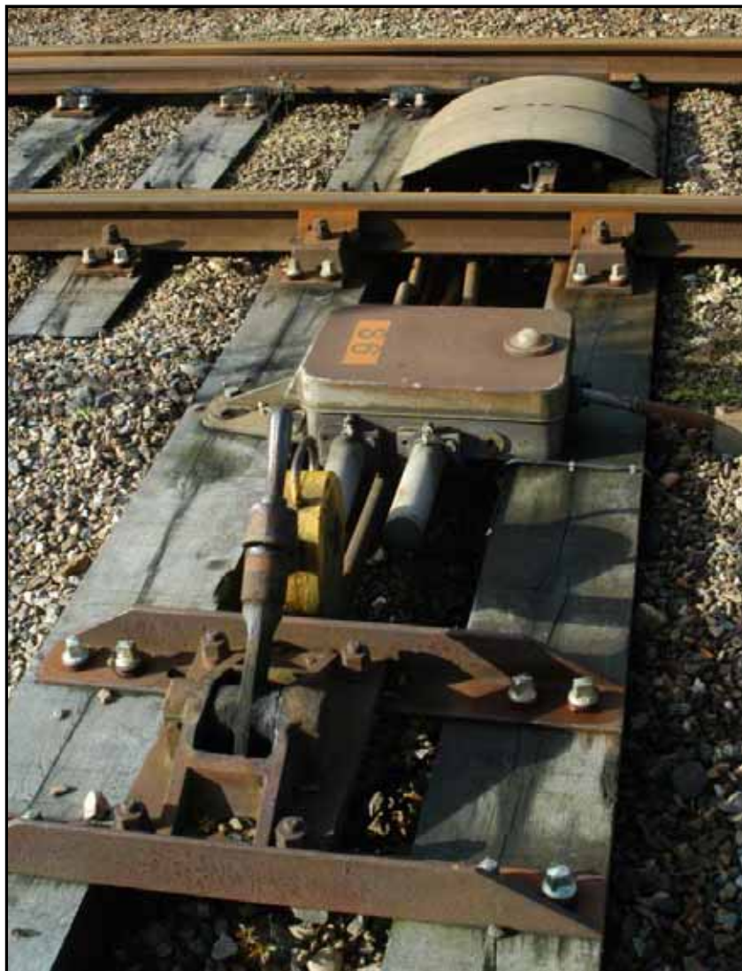
Centralaflåst sporskifte med magnetlås
