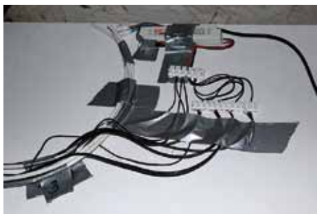
Rozvod pro kamerový systém Electrics for the video camera system
