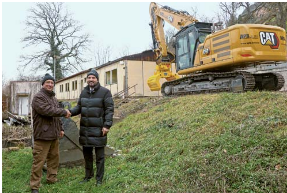
Demolice zemního objektu v areálu bývalé kynologické základny. Demolice zemního objektu v areálu bývalé kynologické základny
