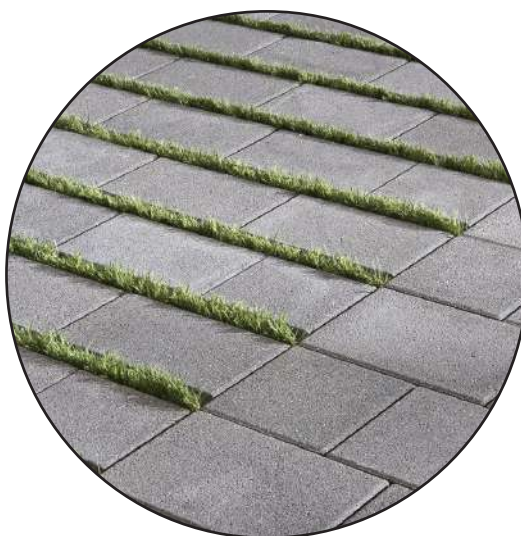
Rozvolnění dlažby u výsadby stromů
