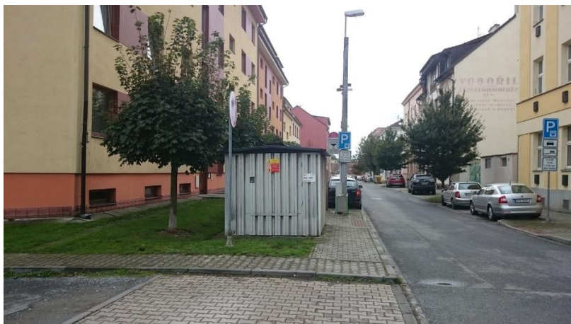
Volně stojící kiosková plechová TS, Bělohorská ulice Nevhodné umístění TS v uličním prostoru, v nárožní poloze, vizuální bariéra
