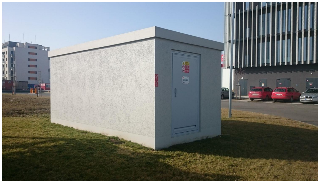
Volně stojící betonová kiosková trafostanice o rozměrech 6 x 3 m a výšce 2,6 m
