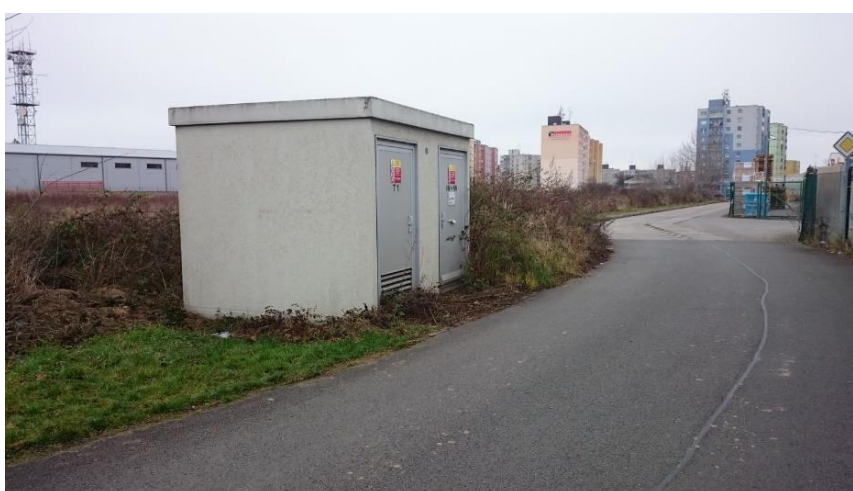
Volně stojící kiosková betonová TS, slepá ulice ve výrobním areálu Košutka Nevhodné umístění TS v blízkosti vozovky
