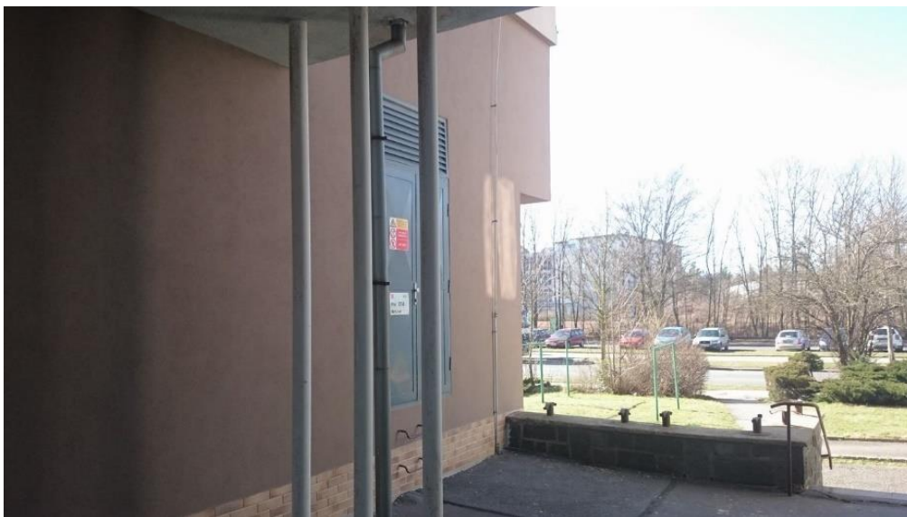
Vestavěná TS obsluhovaná z průchodu mezi domy, ulice U Borského parku
