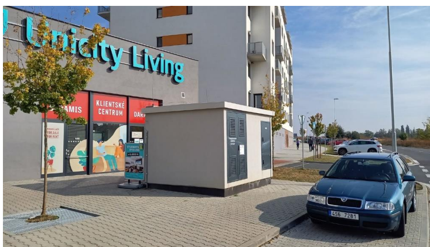
Volně stojící kiosková betonová TS, Magisterská ulice
