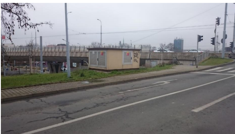
Volně stojící kiosková betonová TS, Mikulášská ulice Nevhodné umístění TS na pohledově exponovaném místě uličního prostoru
