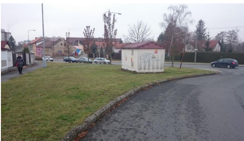
Volně stojící kiosková plechová TS, třída Vojtěcha Rojka Nevhodné umístění TS na pohledově exponovaném místě uličního prostoru; nevhodná střecha i fasáda
