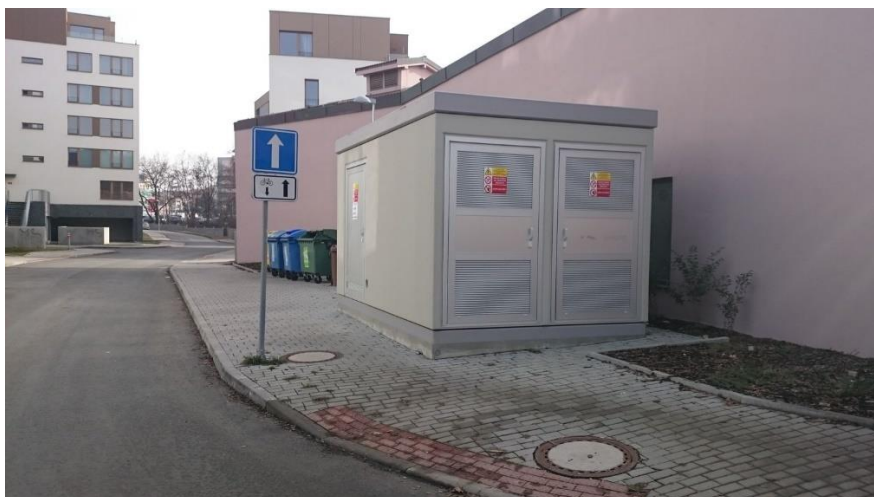
Volně stojící kiosková betonová TS, Pallova ulice
