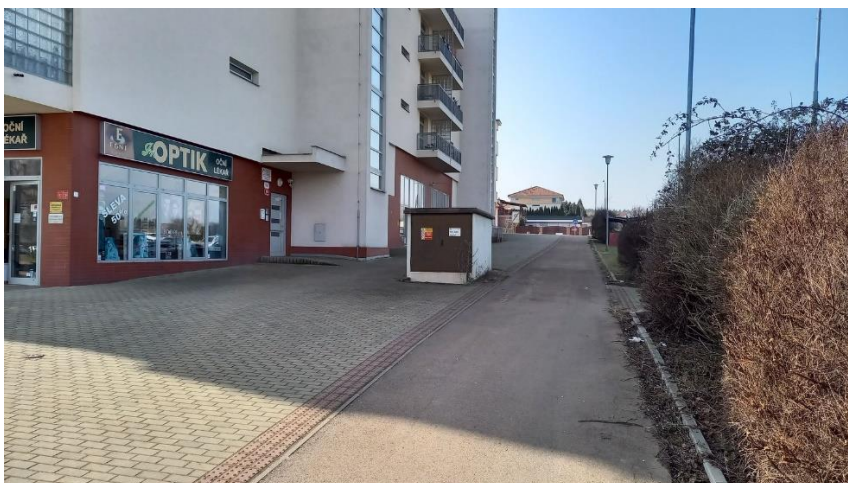
Volně stojící kiosková betonová TS, Hodonínská ulice Nevhodné umístění TS v uličním prostoru; vizuální a prostorová bariéra
