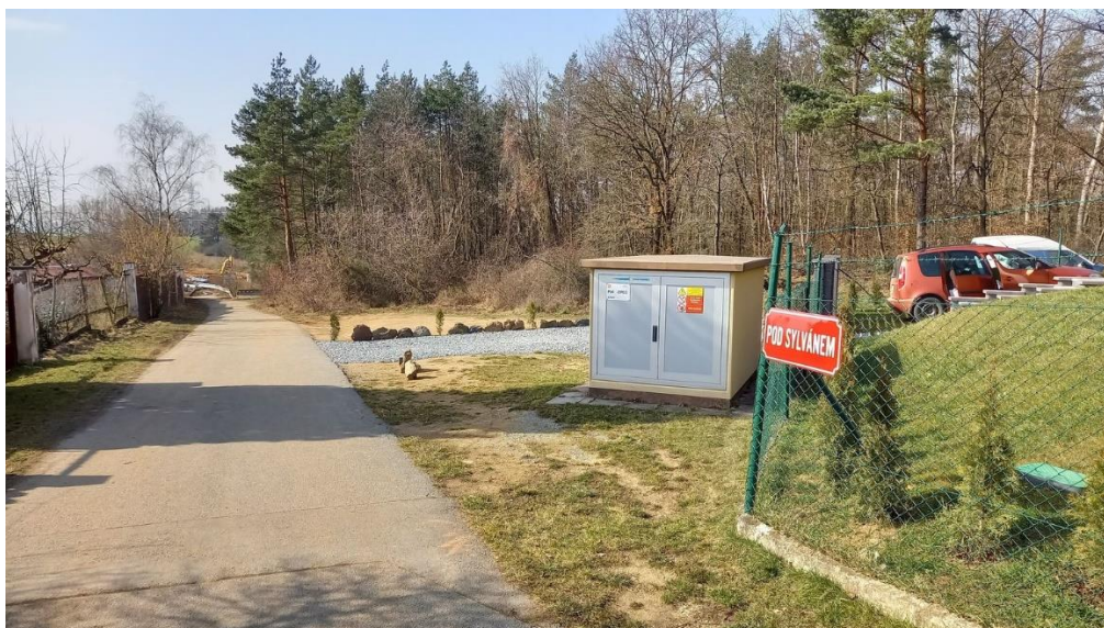
Volně stojící kiosková betonová TS, ul. Pod Sylvánem
