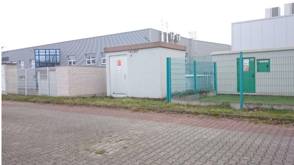
Volně stojící kiosková betonová TS umístěná v oplocení výrobního areálu, Podnikatelská ulice
