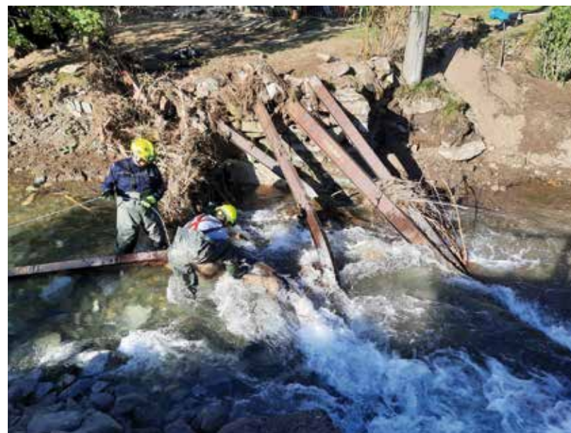
V obci Vápenná hasiči z Plzeňska odklízeli traverzy po strženém mostu.
