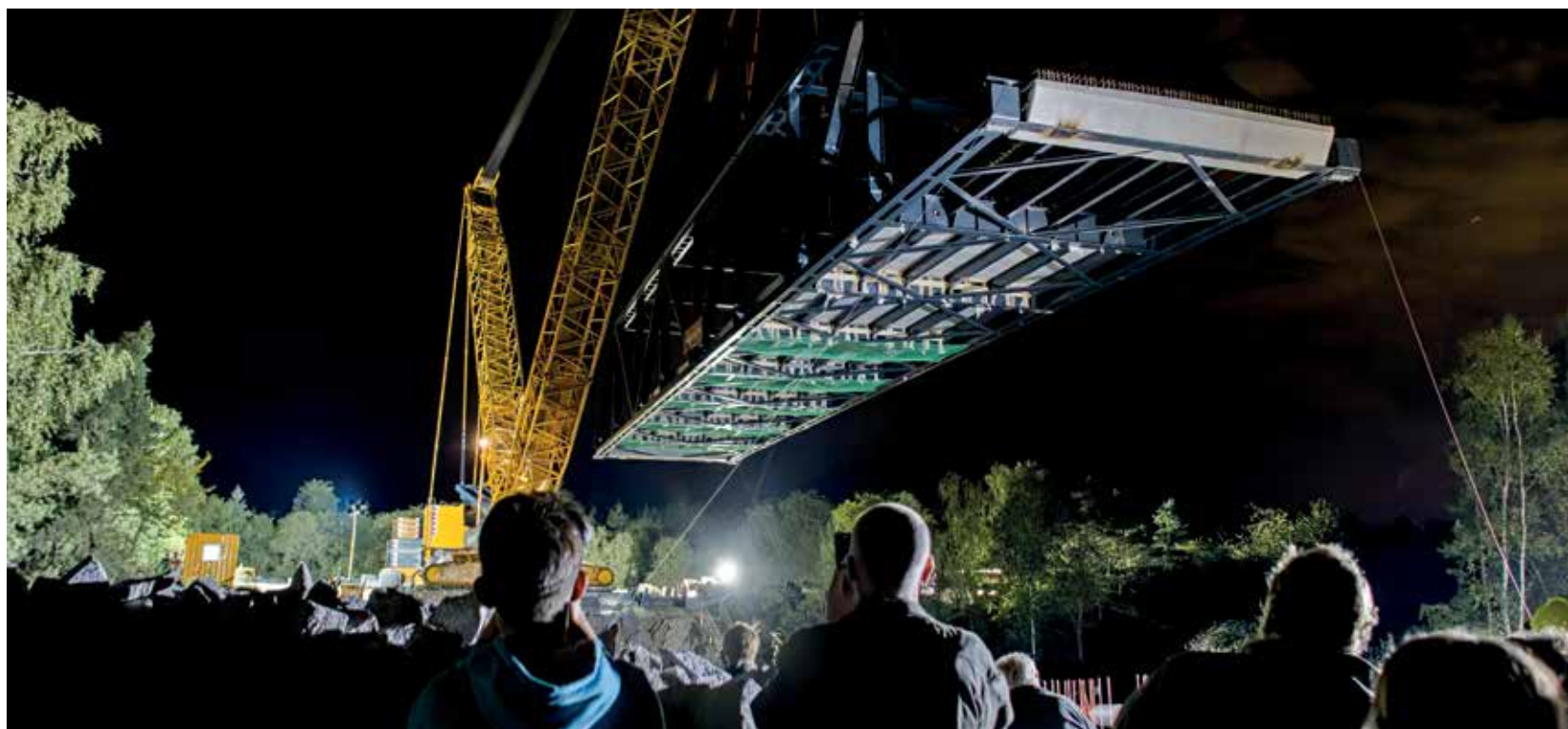
Speciální jeřáb pomohl umístit konstrukci Faltusova mostu na nové opěry vybudované nad zářezem silnice mezi Plzní a Chotíkovem.
