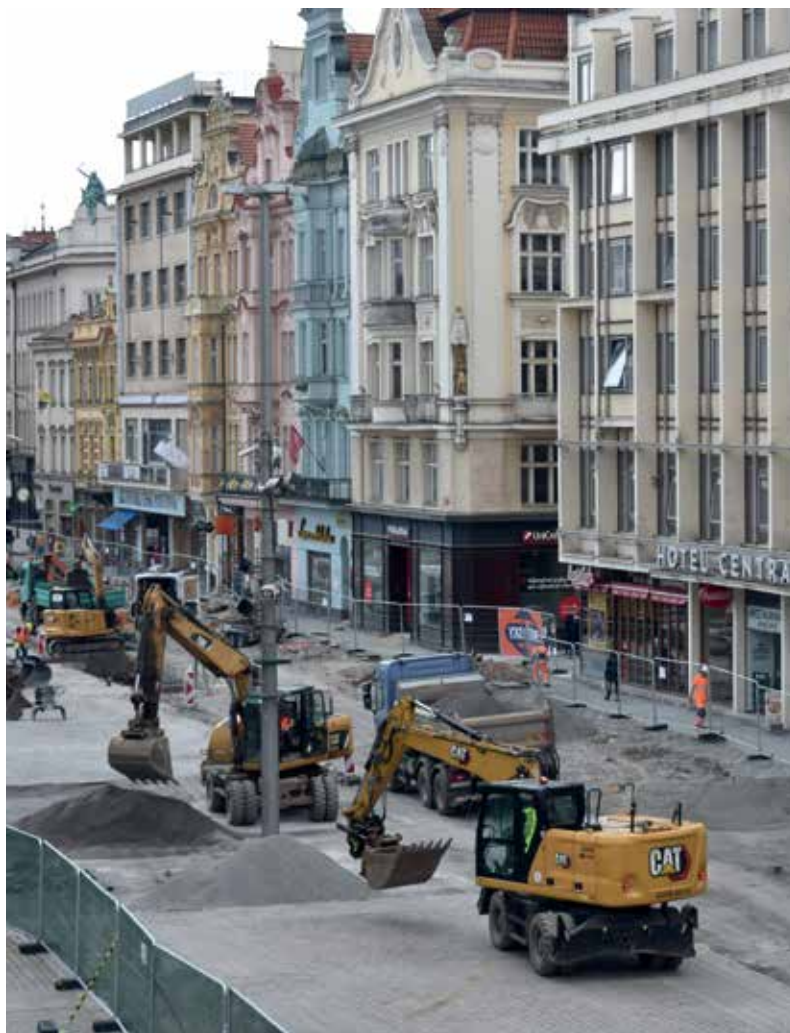
Stavební práce na náměstí Republiky začaly demontáží stávajících povrchů a bouráním dlažby. Foto: Hana Josefová
