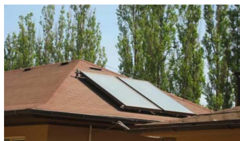
Sluneční kolektory k ohřevu vody v areálu ZOO Plzeň (zdroj: archiv autorů)
