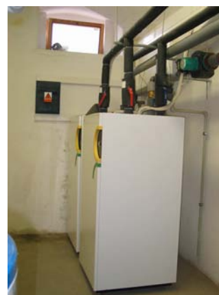
2 ks tepelných čerpadel v objektu Lochoťská 37 (zdroj: archiv autorů)
