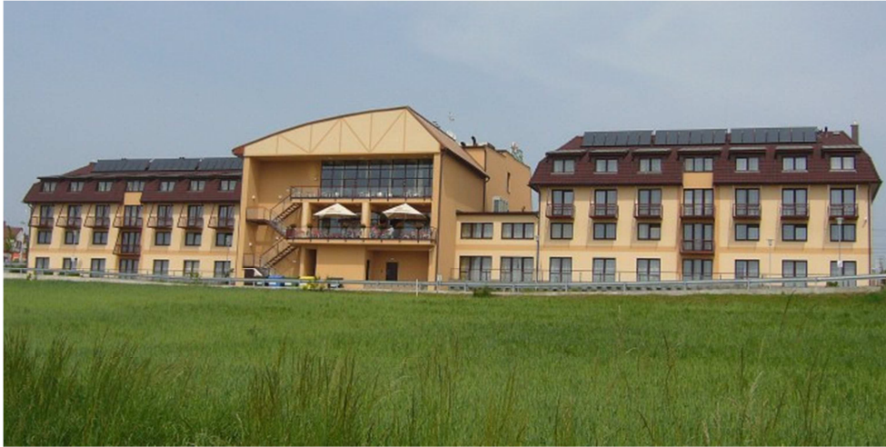
Příklad instalace teplovodních kolektorů na hotelu PRIMAVERA v Plzni – Bručňé
