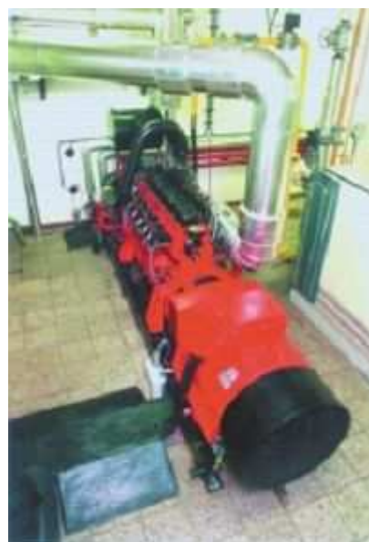
Kogenerační jednotka se spalovacím motorem
