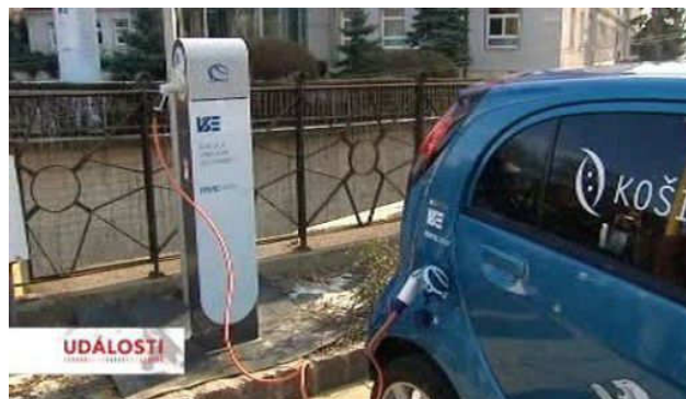
Dobíjecí stanice v Košicích (zdroj: http://www.hybrid.cz )
