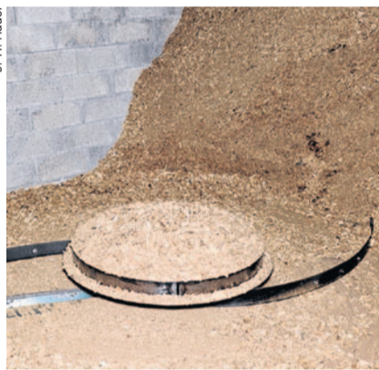
Les copeaux sont acheminés de la réserve à la chaudière en permanence
