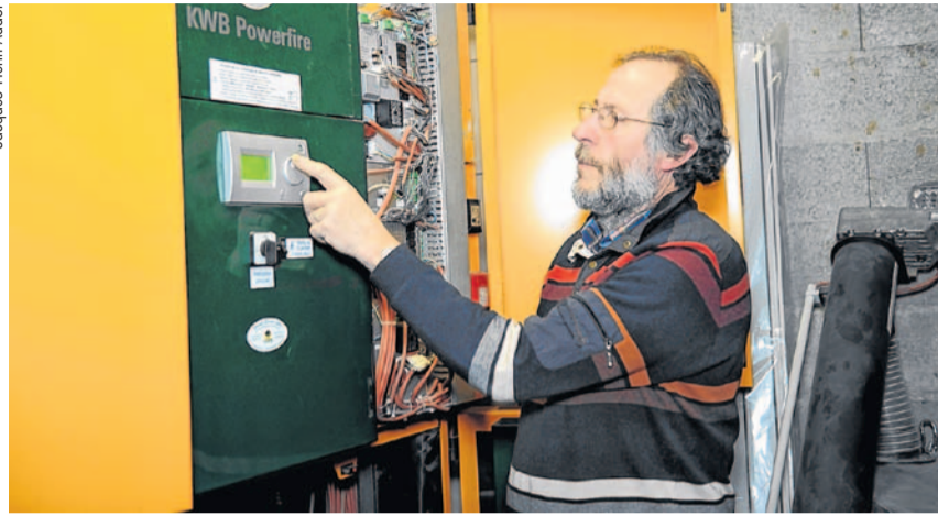
La chaudière à bois déchiqueté installée chez Denis Candaux alimente neuf appartements et les locaux de la commune de Premier
