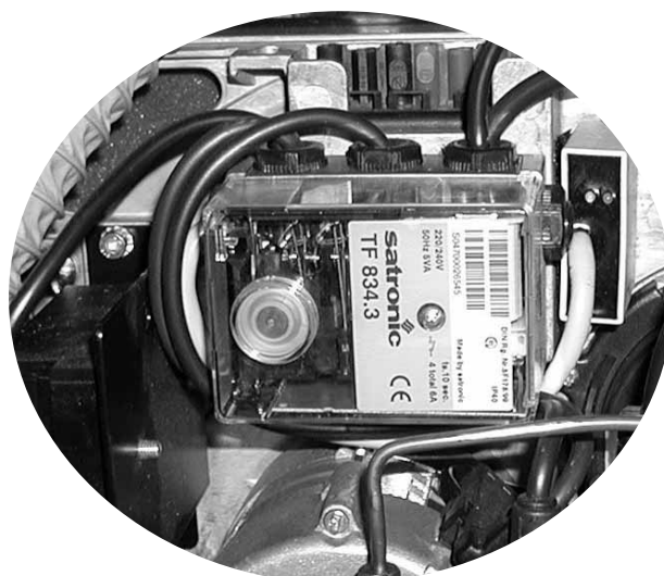
Detail-Ansicht Feuerungsautomat des SÖ NT mit Reset-Knopf
