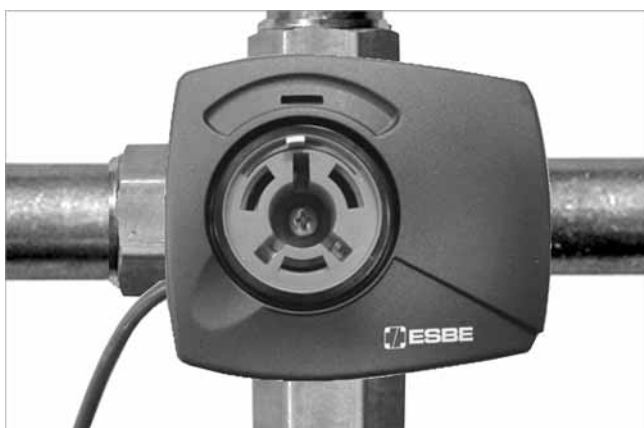
Fig. 22: Servomotor con válvula mezcladora
