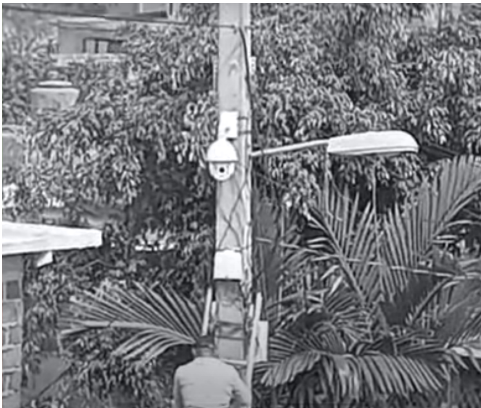
Cámara de vigilancia instalada cerca de la sede de la UNPACU. FUENTE: UNPACU/ YOUTUBE.
