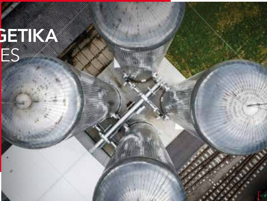
Nádrže akumulace horké vody v teplárně Dvůr Králové Thermal accumulation tanks in Heating Plant Dvůr Králové
