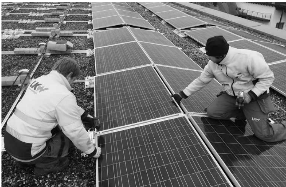
Solaranlage auf der Primarschule Äule.
