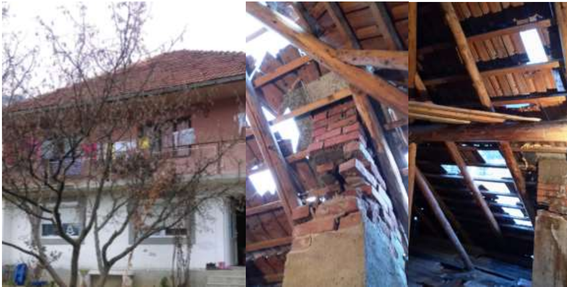
Slika br. 20 Plav 2018. godina, Brezojevica: a) Zidana kuća iz 1974.godine (A.B. stubovi i ploča; prizemlje je zidano kamenom, a sprat je dozidan blok-opekam. Kuća nije pretrpjela značajna konstruktivnih oštećenja, dok su krov i dimnjaci značajnije oštećeni (u vrijeme fotografisana krov je u većoj mjeri saniran)
