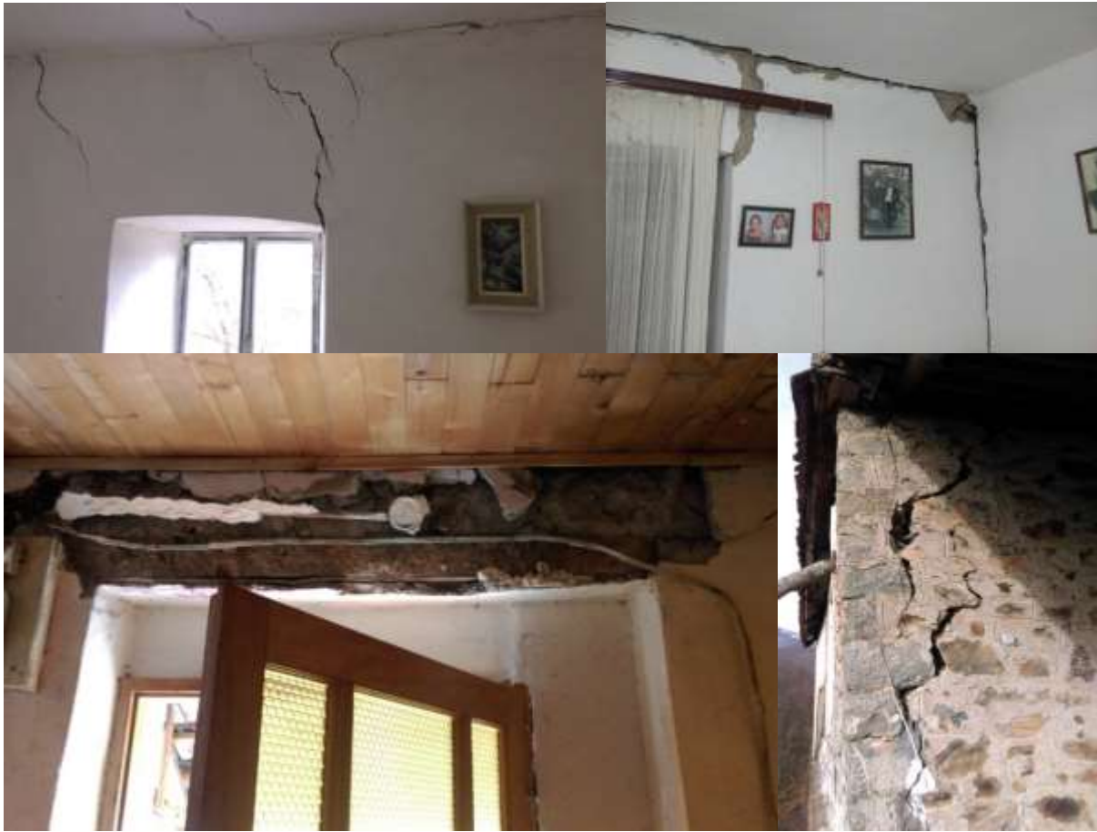
Slika br. 18 Plav, 2018. godine: Tipični izgled unutrašnjosti najoštećenijih tradicionalnih kamenih kuća – otpadanje maltera duž odvojenih spojeva zidova, dijagonalne pukotine oko otvora u zidovima
