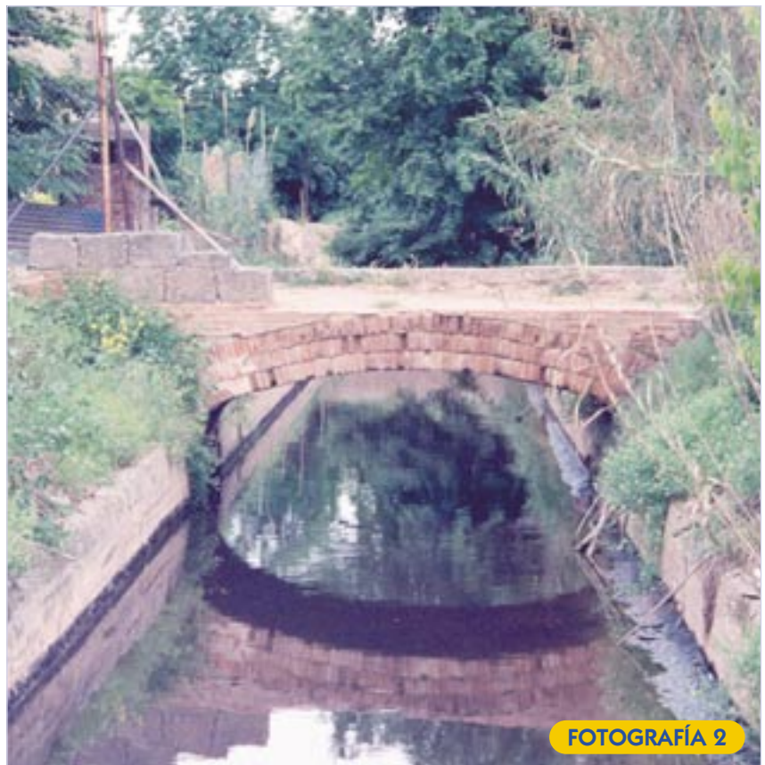
Aspecto de uno de los puentes que daban continuidad a la red de caminos interceptados por el Canal de la Infanta.
