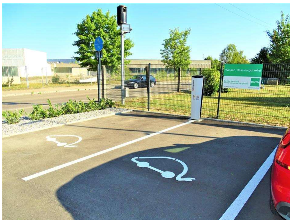
4 x Parkplätze mit E-Ladestationen
