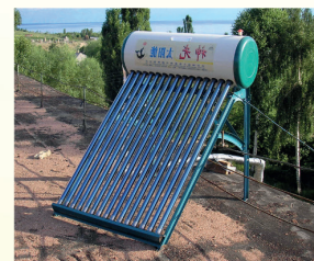
Вакуумный солнечный водонагреватель, установленный в средней школе (с. Ак-Терек, Иссык-Кульская обл.)
