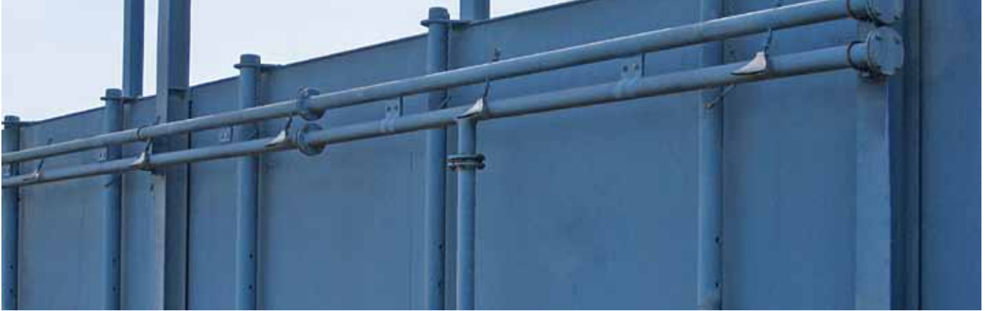
Sprüheinrichtung der Putsch® Rundkläranlage zur gezielten Reduktion der Schaumbildung Spray system of the Putsch® Flume Water Clarifier to decrease the formation of foam Dispositivo pulverizador del depósito clarificador Putsch® para la reducción del lodo obtenida
