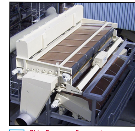
24 Chip Recovery System / Traitement des radicoles / Procesamiento de fragmentos de remolacha
