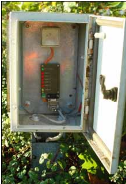
Betjeningskasse for kommunalt etablerede advarselssignalanlæg
