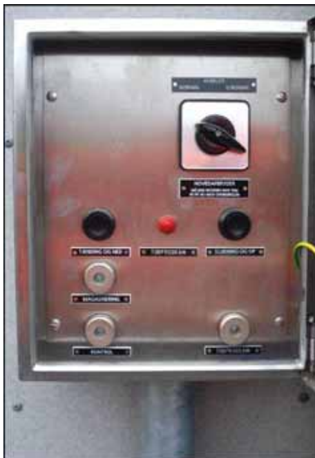
Betjeningskasse for overkørsel 0b nord for Sjællandsgade
