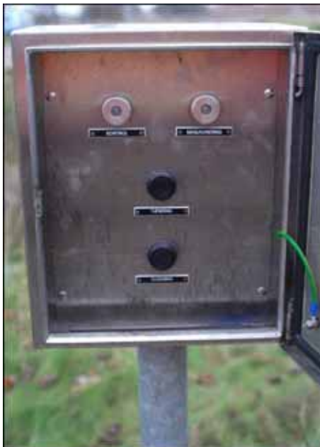
Betjeningskasse for overkørsel 0b syd for overkørslen
