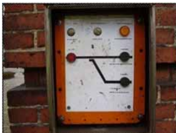
Betjeningskasse på husgavlen ved firmaet H. Daugaard.
