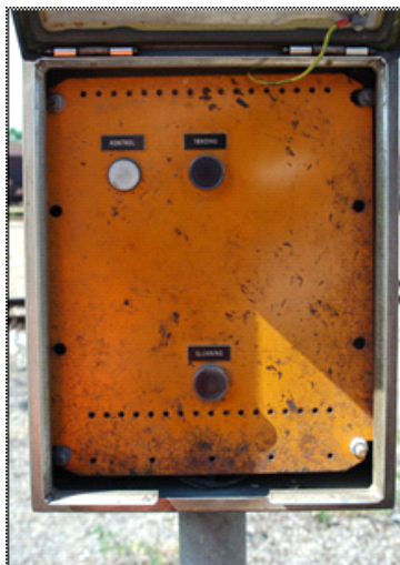
Betjeningskasse ved Jens Holmsvej.
