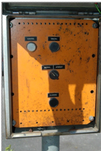
Betjeningskasse ved Nordkajen.
