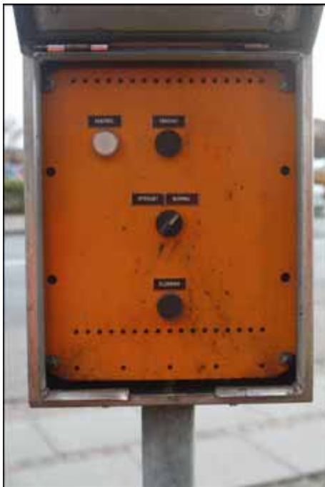
Betjeningskasse for overkørslen i Toldbodgade syd for overkørslen
